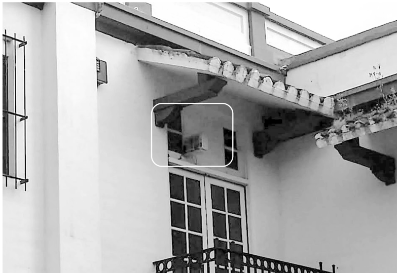
Figura 25. Nodo IoT instalado en fachada de edificio en la Utec. Fuente: diseño
