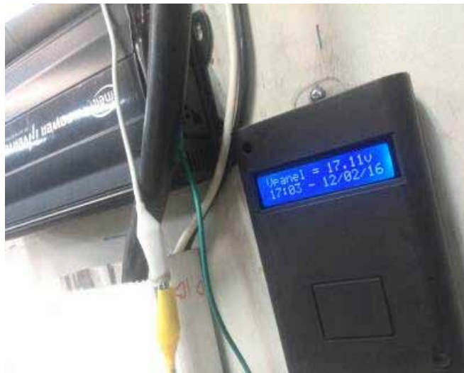
Fig. 4.5. Vista frontal prototipo de monitoreo instalado junto a la acometida del panel solar
